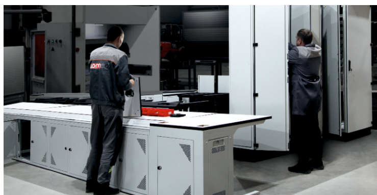
Монтаж «под ключ» на объекте заказчика
